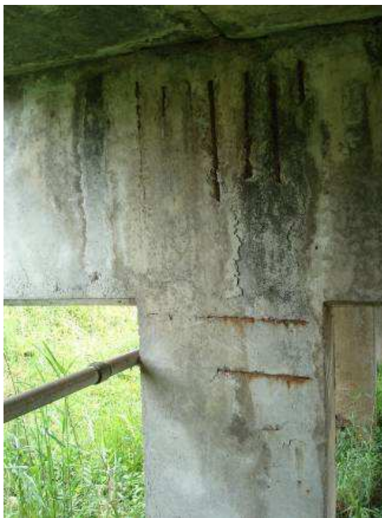
Figura 22 – Pórtico com corrosão de armadura
