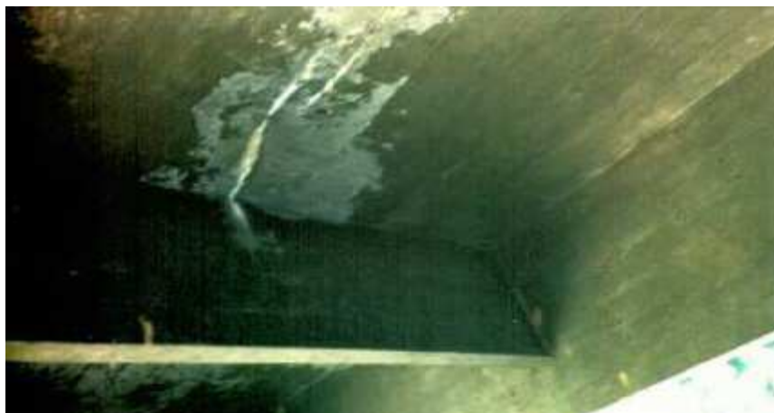
Figura 6 – Exemplo de manchas superficiais no concreto, fonte DNER 1994.
