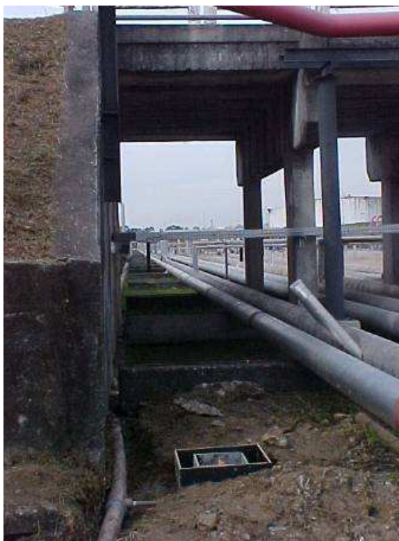
Figura 2 – Foto exemplificando a transposição de tubulações de hidrocarbonetos e seus derivados sob um pontilhão na REPAR.
