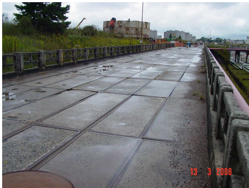
Figura 19 – Desagregação do concreto nas placas do tabuleiro
