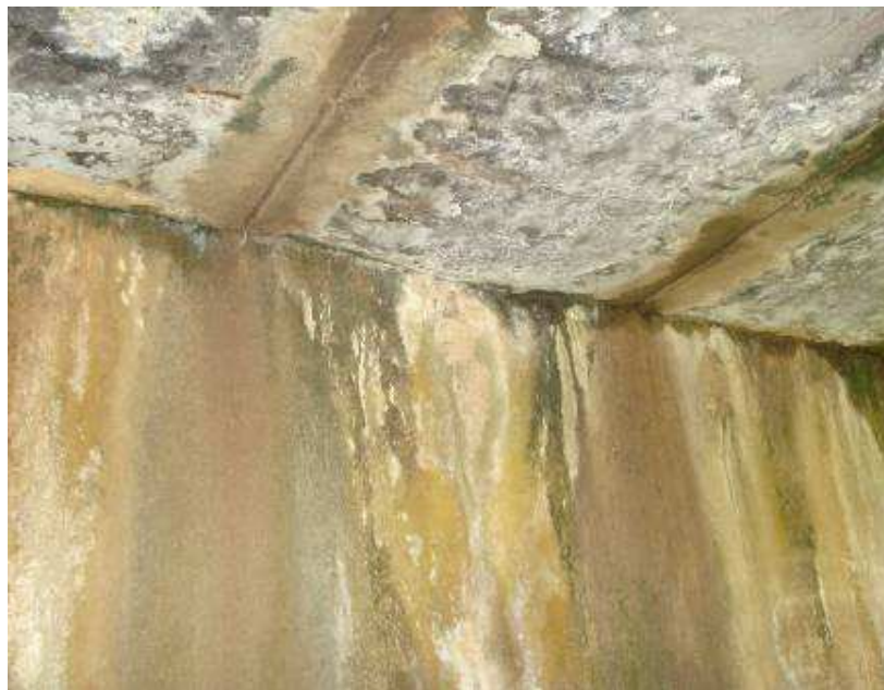
Figura 20 – Eflorescência na face inferior do tabuleiro
