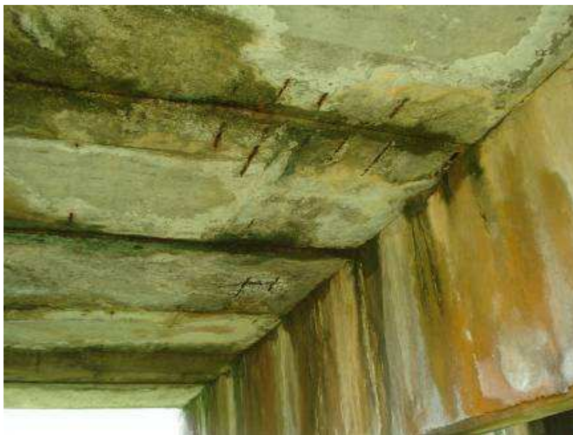
Figura 21 – Presença de fungos na face inferior do tabuleiro
