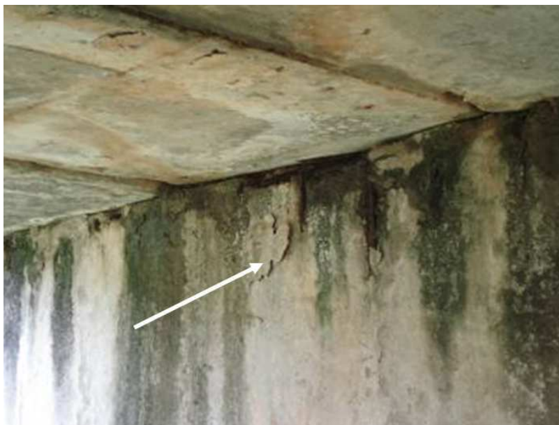
Figura 23 – Desplacamento de concreto de cobrimento
