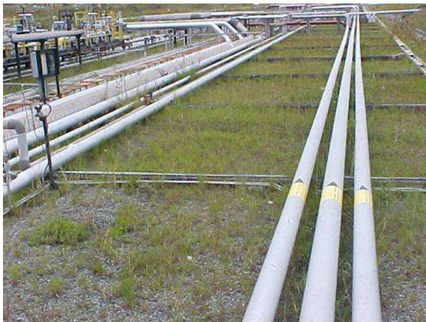
Figura 1 – Foto exemplificando uma tubovia (pipeway) na REPAR.
