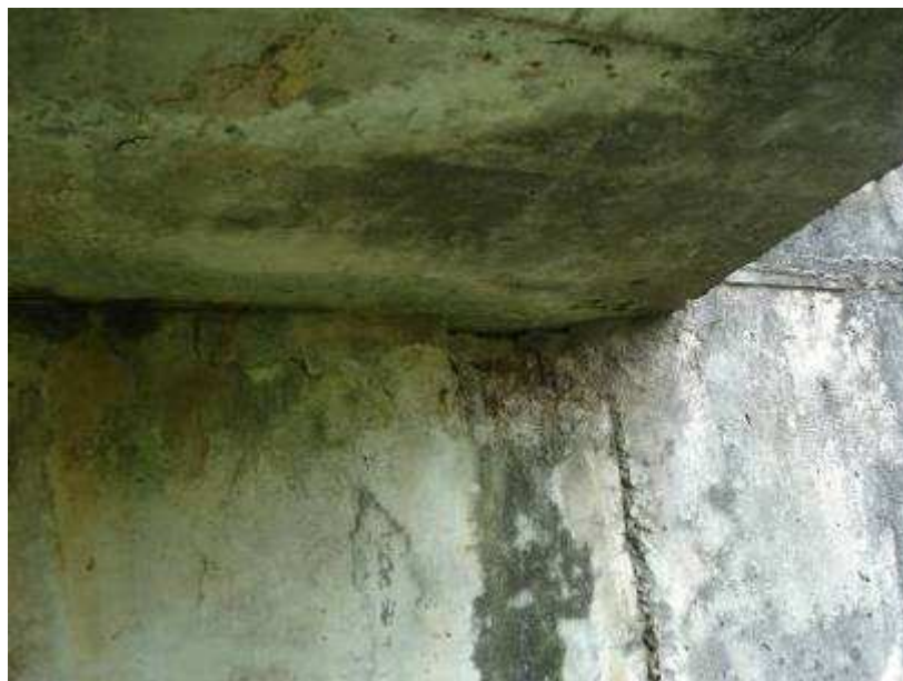
Figura 18 – Inexistência de aparelhos de apoio
